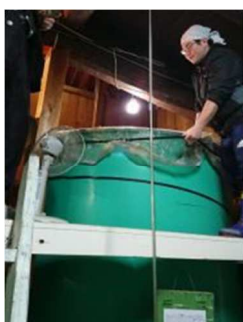
温度センサーを設置する 仕込タンク
