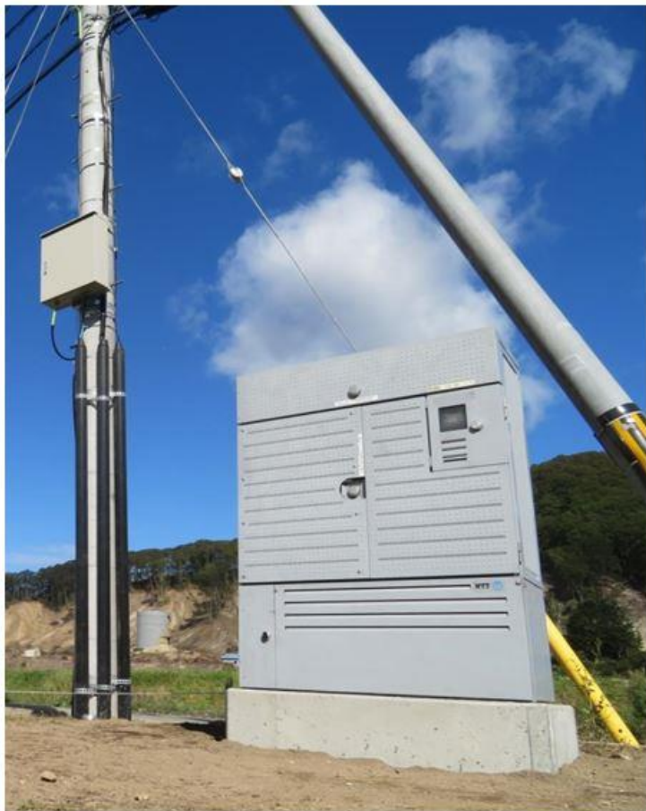
暫定復旧として設置した通信設備
