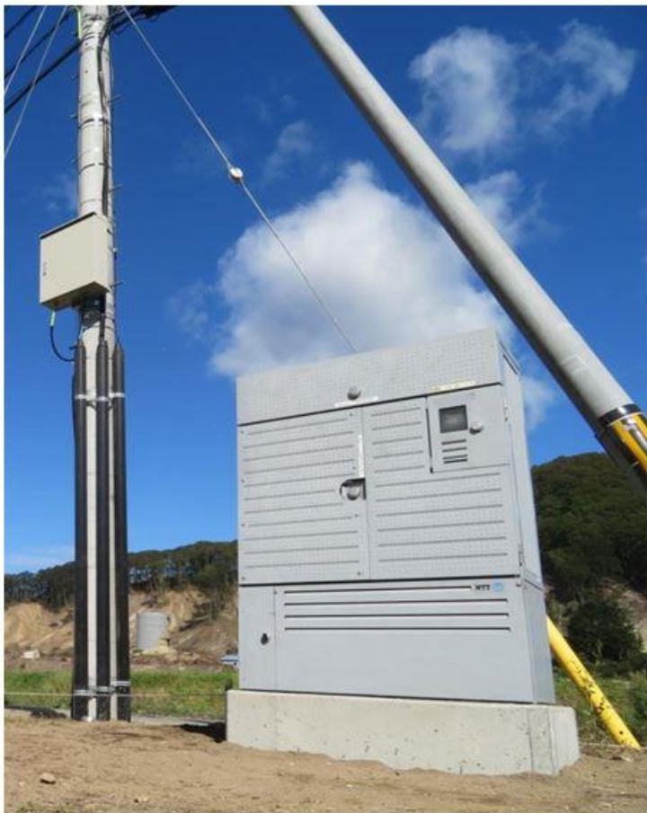
暫定復旧として設置した通信設備
